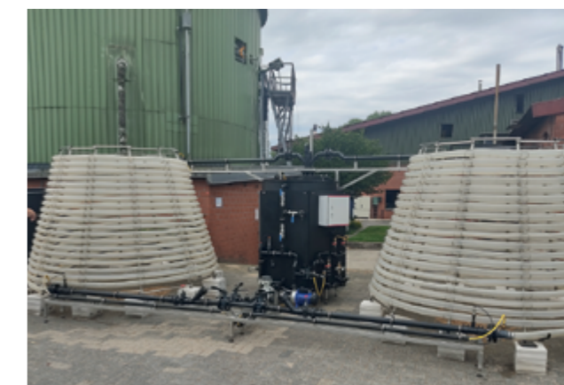
Das anfallende Oberflächenwasser dient zur Kultivierung von Algenbiomasse mittels Röhrenreaktoren.
